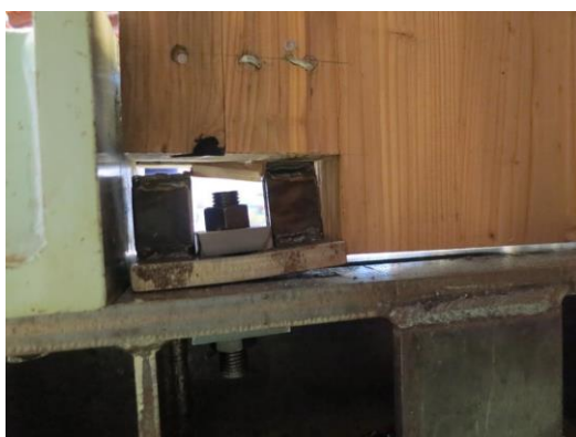
金物の損傷(溶接部が破断)
